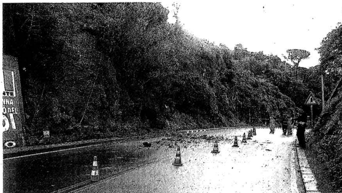
La frana caduta ieri mattina sulla via Aurelia all'altezza di Cavi di Lavagna
