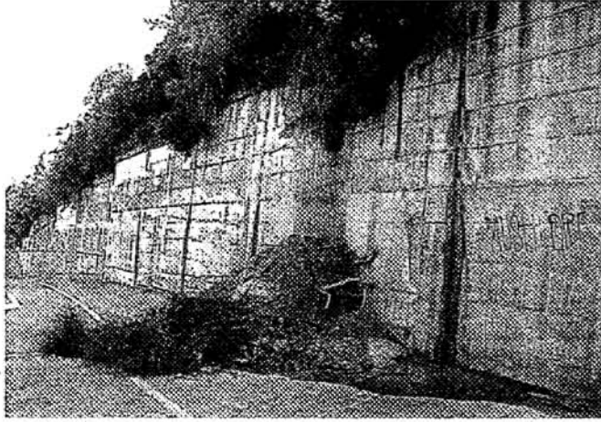
La frana avvenuta a Cavi, dietro l'asilo
